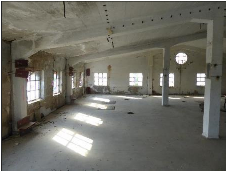
Abb. 7: Das Dachgeschoss auf westlicher Seite ist ausgebaut, ein Großteil der Fenster ist intakt (Foto 17.05.2022).
