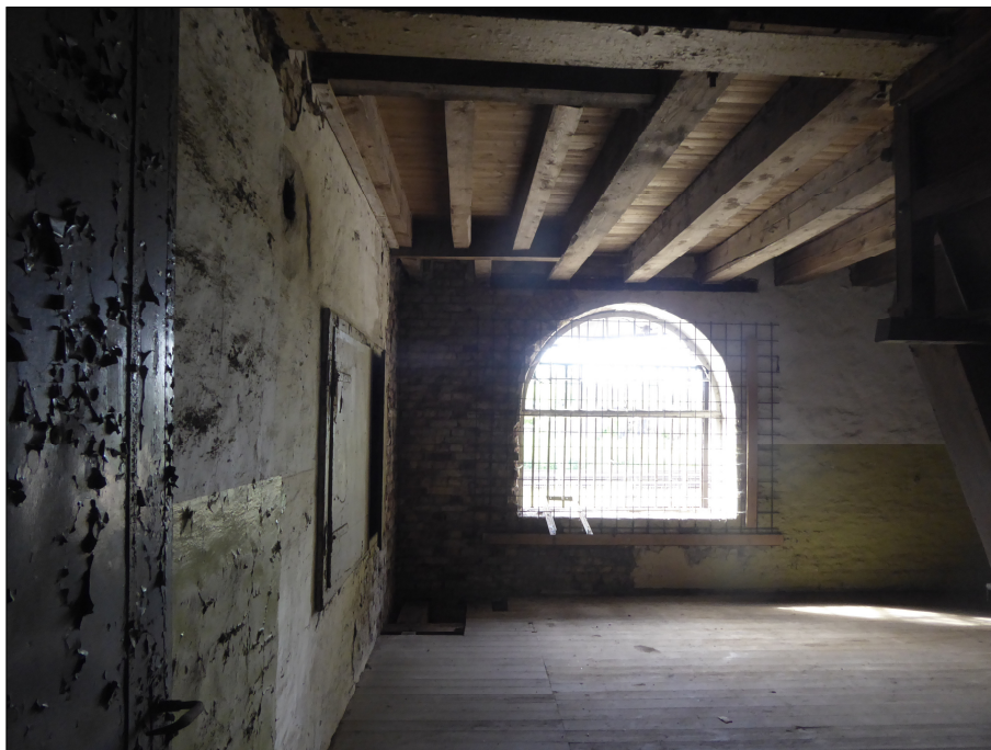
Abb. 6: Der Großteil der Fenster im Keller ist defekt (Foto 17.05.2022).
