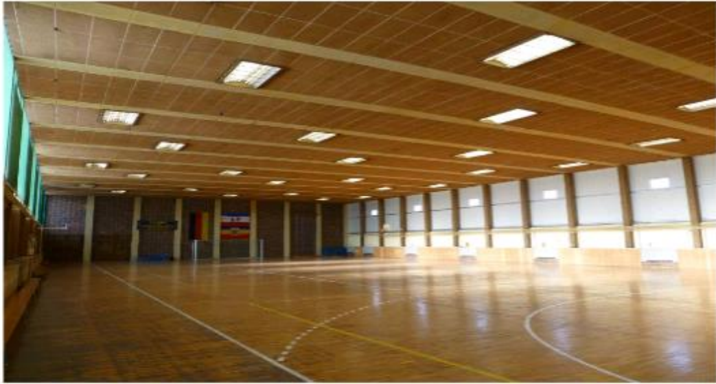
Alte Anlage mit LS-Leuchten
