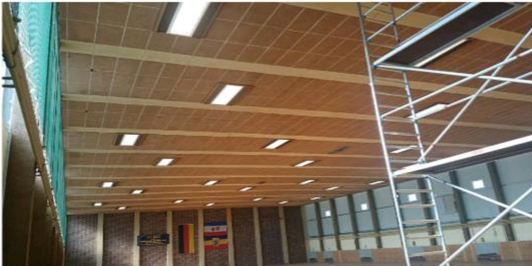
Erneuerte Anlage mit LED Sporthallenleuchten
