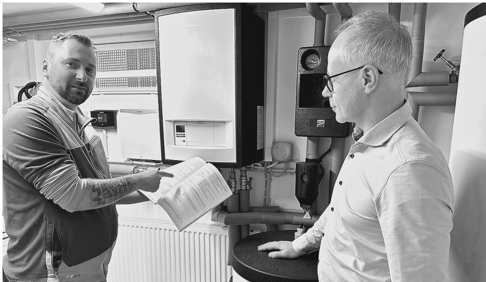
Raik Wulff (links) weist seinen Kunden in die Arbeitsweise seiner modernen Wärmepumpenanlage nach neuestem energetischen Standard ein.
