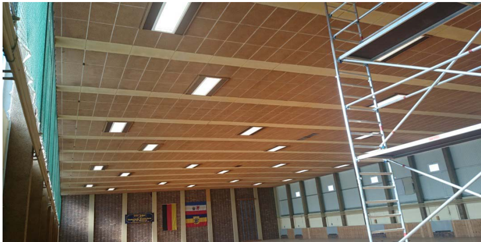
Erneuerte Anlage mit LED Sporthallenleuchten
